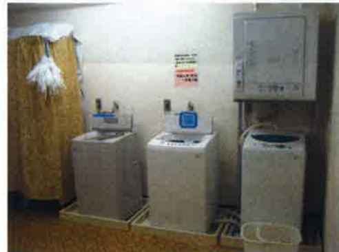
各フロアに2～3台設置
